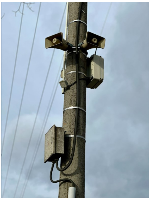
Obrázek 12) První příklad MIS na sloupu elektrického vedení v městyse Kralice na Hané. [tvorba vlastní]
